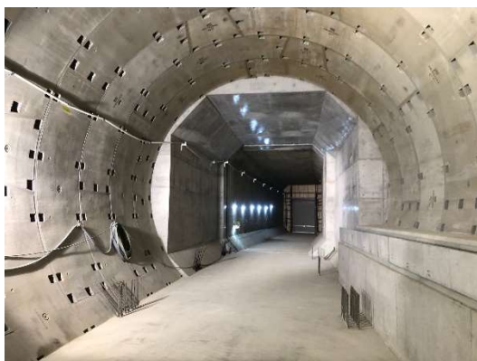
終端覆工後の千里中央駅北端部 (南行シールドトンネル)
